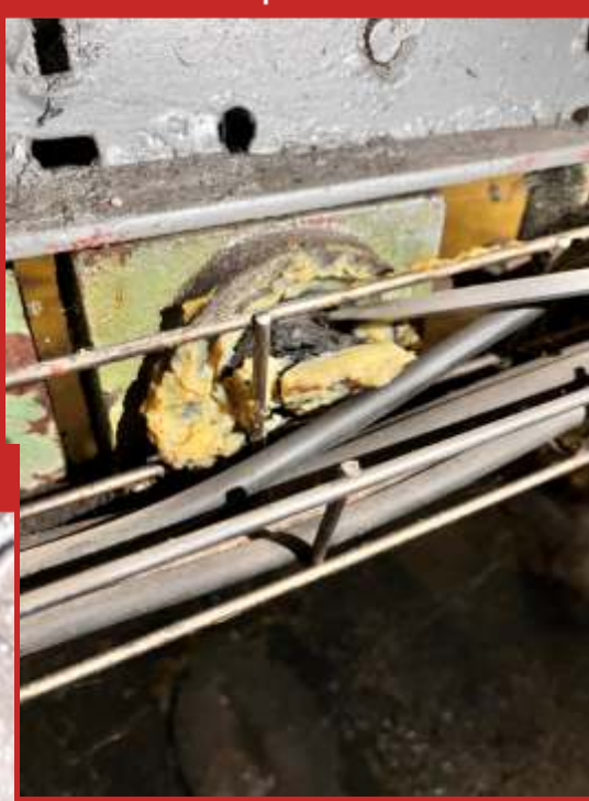
Staré mazivo v poškozeném ložisku
